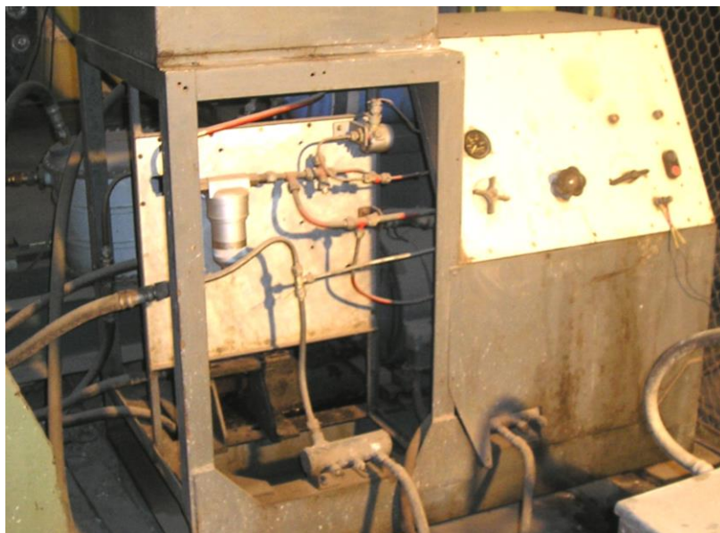
Рисунок 4.5 – Общий вид электрической насосной станции
